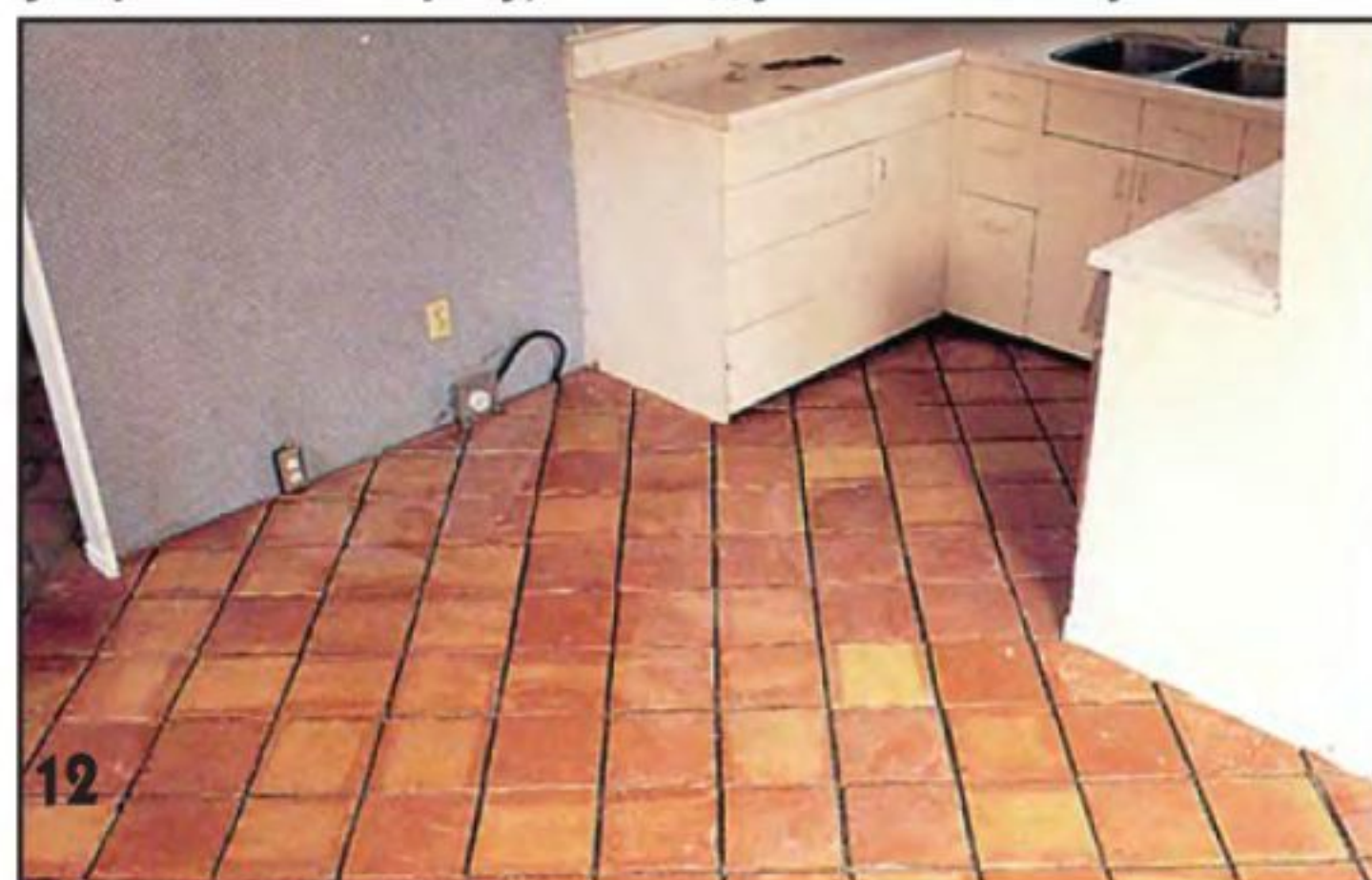
12 Конец первого дня работы. Покрытие готово под затирку. Нужно только смыть с поверхности плиток излишки клея.
