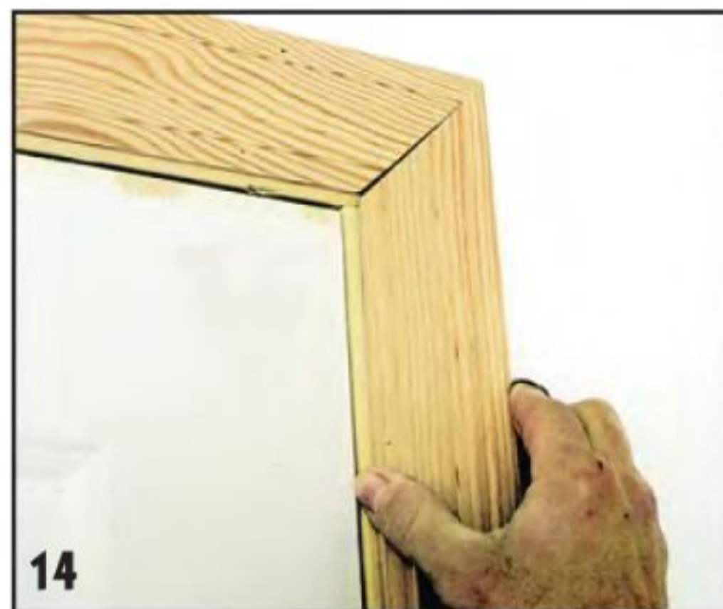
14 Когда кромка обвязки и стена не совпадают, наличники не ложатся плашмя и появляется расходящийся зазор по стыку.
