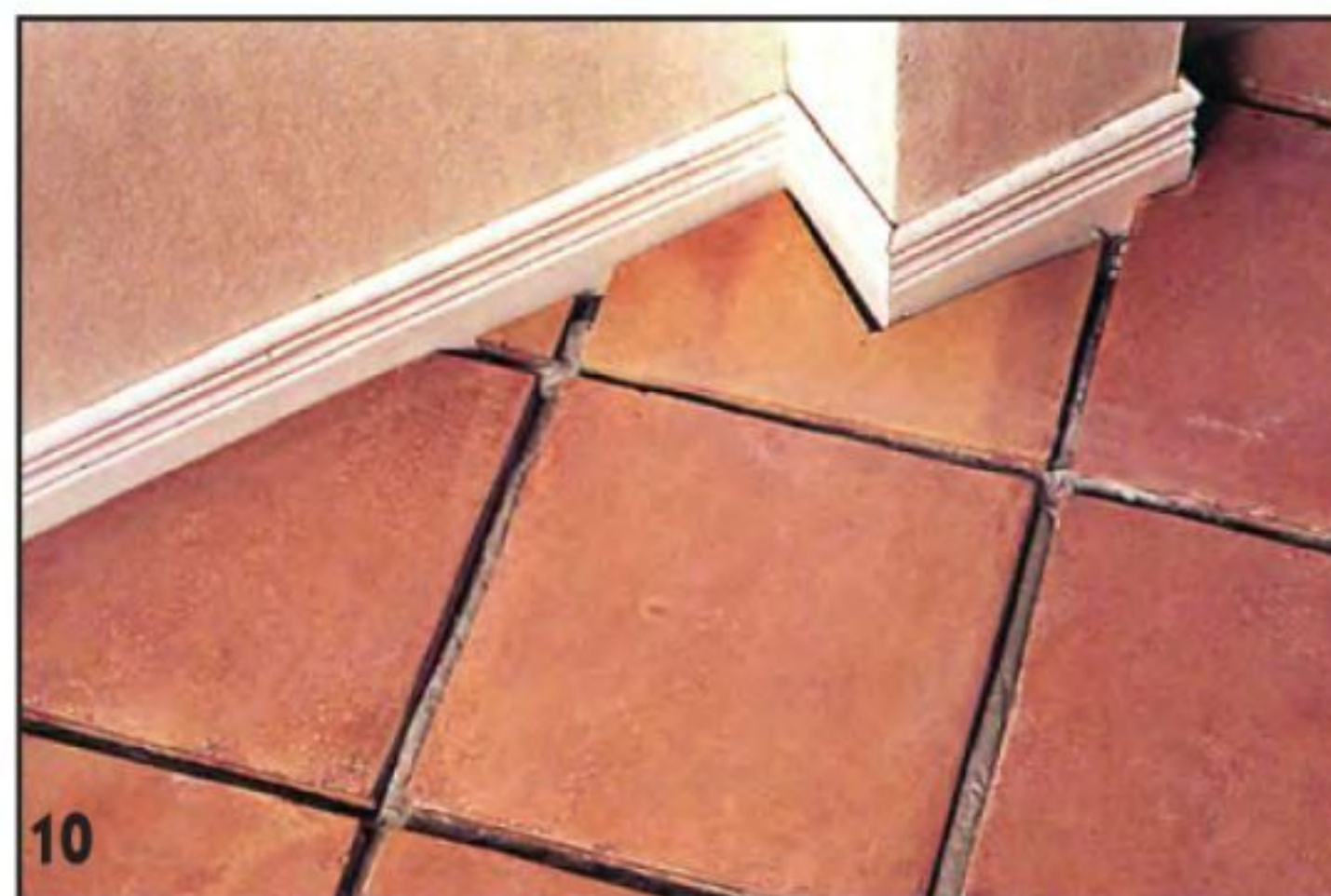
10 Уложенные вдоль стены обрезанные плитки немного больше тех, что использовали у порога. Абсолютно прямых стен не бывает! Этот недостаток будет менее заметен, если настилать плитку параллельно порогу, а не под углом 45° к нему.
