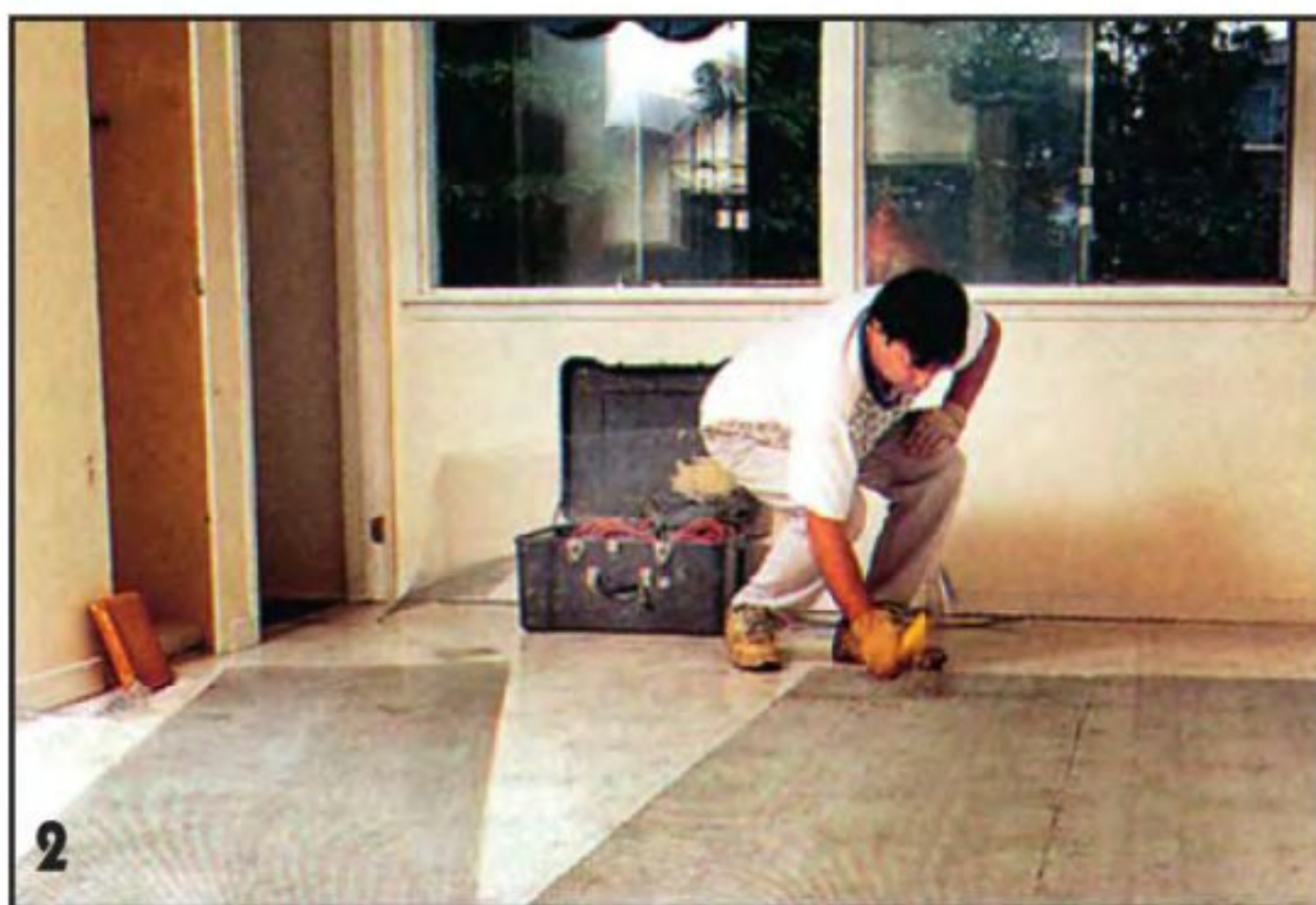
К чёрному полу крепят проволочную сетку скобками с помощью степлера. Сетка сделает слой плиточного клея более прочным.
