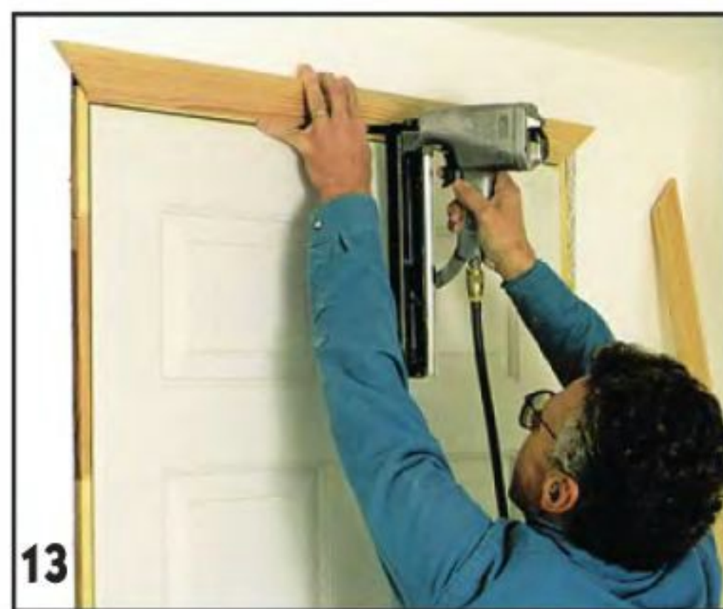
13 Ставят наличники. Первым крепят верхний наличник. Его прибивают двумя парами гвоздей с интервалом 40 см. Один гвоздь каждой пары забивают в обвязку, другой — в перемычку проёма стены.
