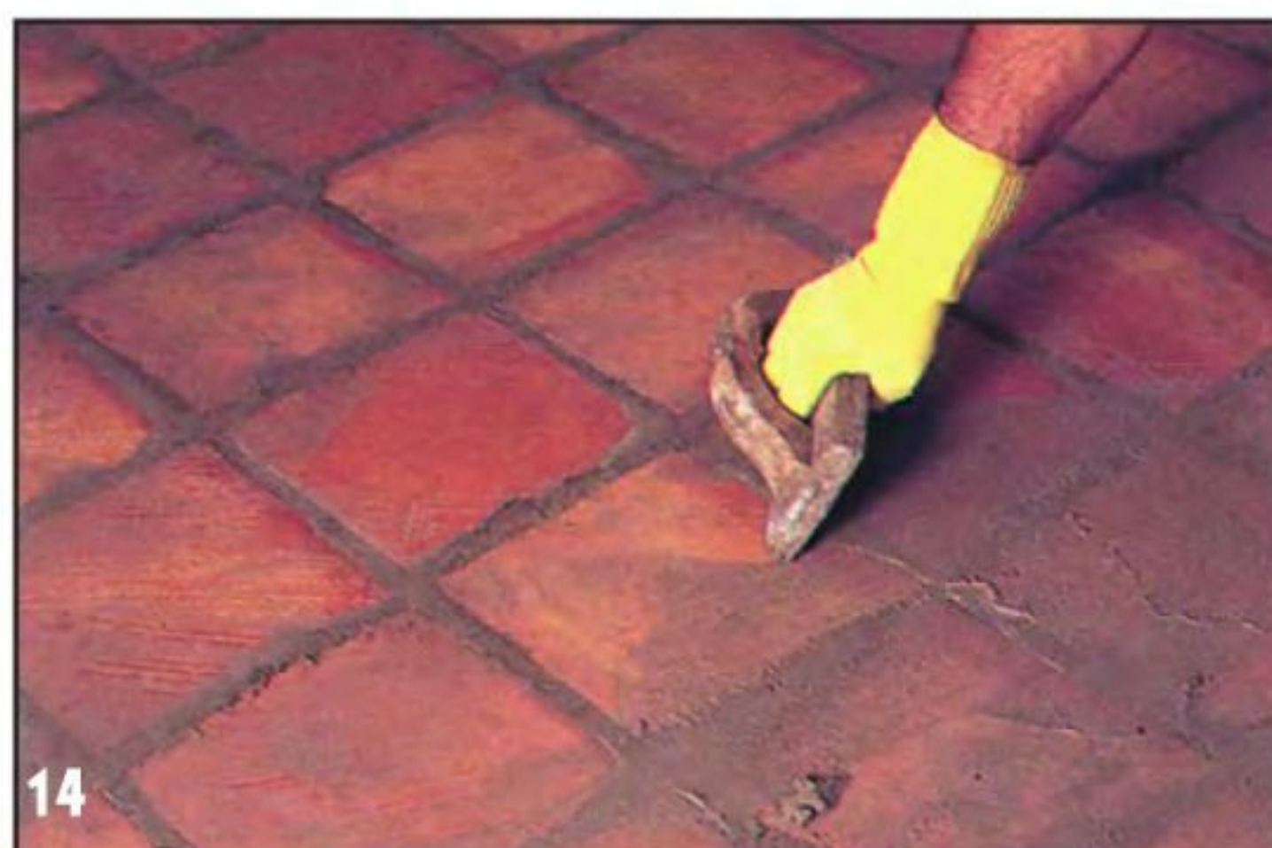
Обработав выделенный участок покрытия, ребром обрезиненной тёрки уплотняют затирочный раствор в швах. Здесь под рукой следует держать маленький пластмассовый шпатель для заделки «узких мест».
